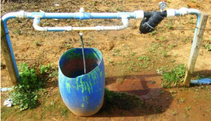
Figura 10. Sistema de Fertirrigação.
